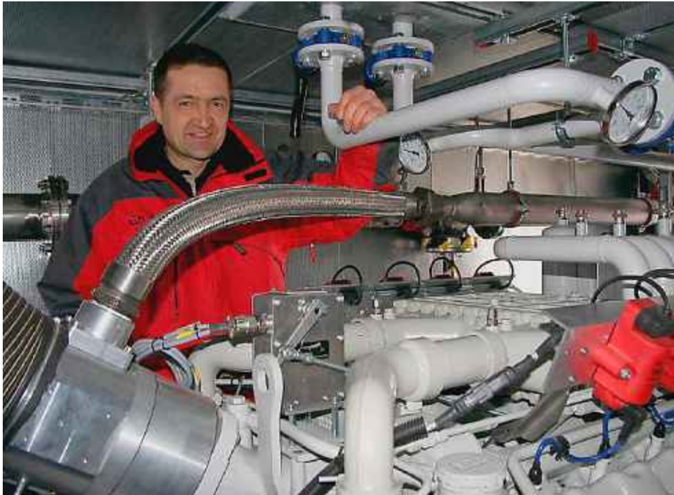
GBAB-Betriebsleiter Holger Ehmann vor dem Acht-Zylinder-Gasmotor im Blockheizkraftwerk: Hier wird das durch den Vergärungsprozess erzeugte Biogas eingeleitet und über einen Generator in Strom und Wärme umgewandelt.
